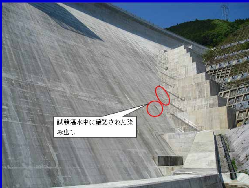
試験湛水中に確認された染み出しの例
