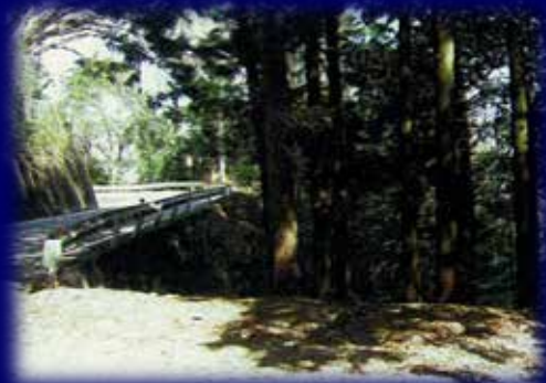
線形不良状況
