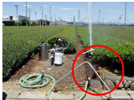
給水栓から用水供給
