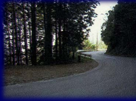
②線形不良状況
