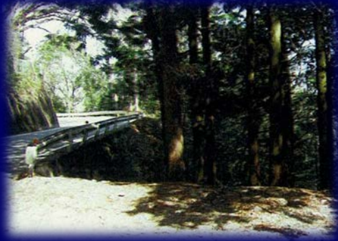
①線形不良状況
