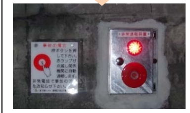
押しボタン式通報装置
