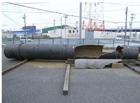
撤去された破損管の状況
