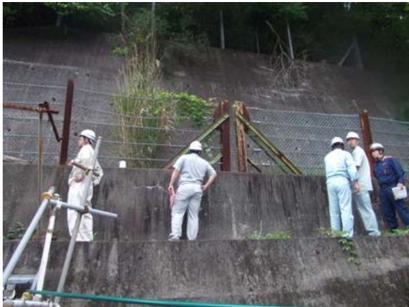
急傾斜地パトロール（沼津土木事務所） ・ 防護柵の損傷を確認中
