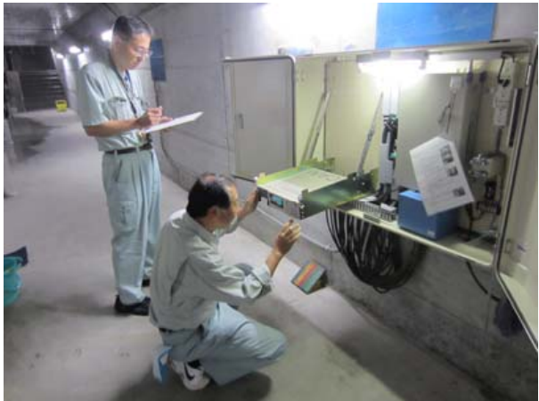
日常巡視（袋井土木事務所） ・ 観測データを取得中
