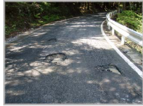
3. 危険・即補修
