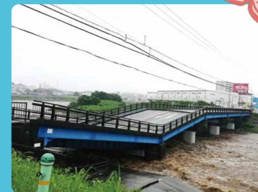
大雨時に橋が壊れた静岡県内の事例(2021年7月)
