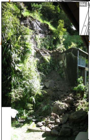
人家裏の小崩落 (H22.8)
