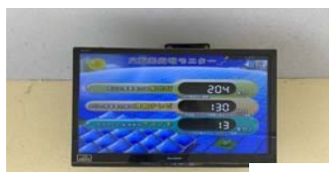
発電モニター
