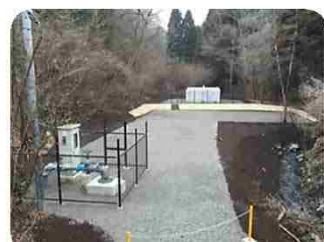
水源揚水井戸（御殿場市）
