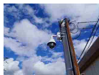
WEBカメラ設置 （富士市浮島排水機場）
