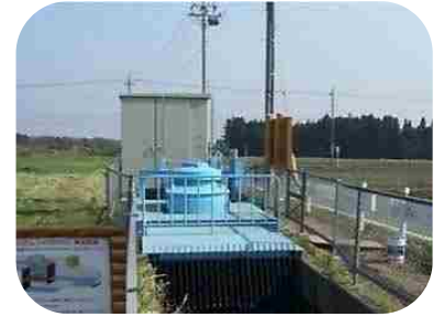
小水力発電所の整備
