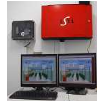
(環境制御装置)
