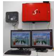
(環境制御装置)
