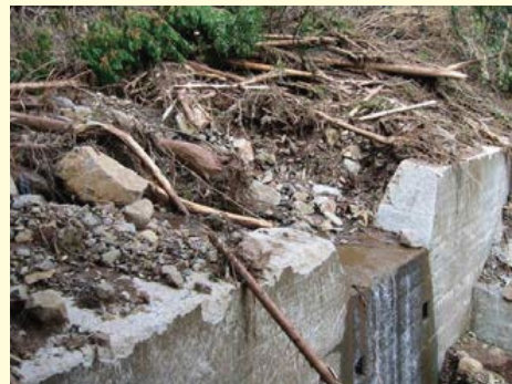
谷止工による 流木の捕捉
