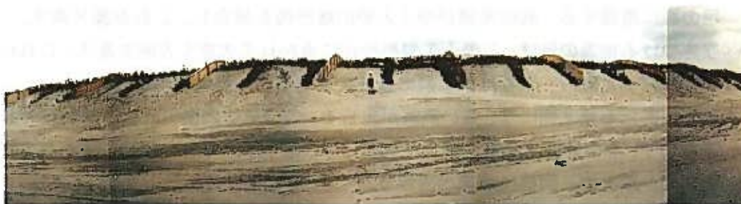
竹簀及びそだを利用した堆砂垣の設置状況(浜岡町合戸 平成8年度施工)
