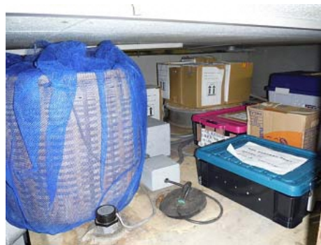
写真2 富士山測候所倉庫内の設置状況
