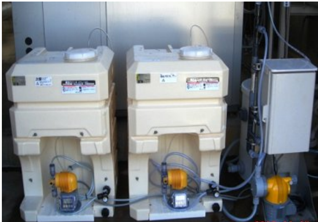
写真1 モノクロラミン自動生成・注入装置
