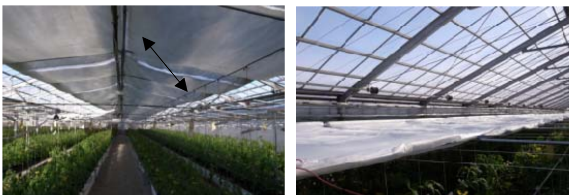
図2 実用温室に設置した省エネ隔離室（左：傾斜開閉方式、右；水平開閉方式）
