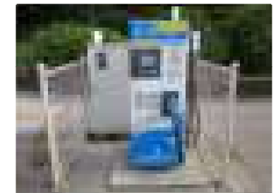
県庁のEV用急速充電器
