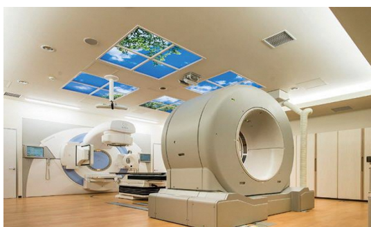
<先端医学棟1階 放射線治療室>
