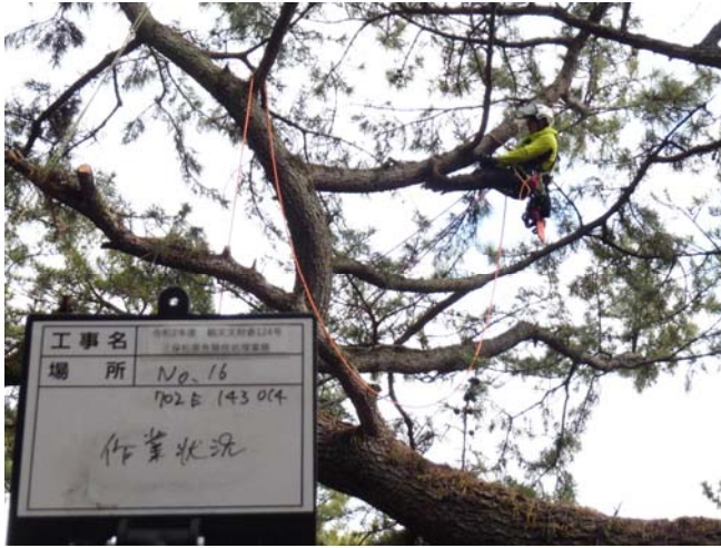
ツリークライミングで高所に登り、チェーンソーで枯れ枝や折れ枝を除去する作業
