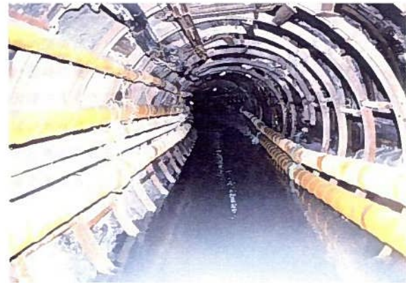
写真 配管状況
