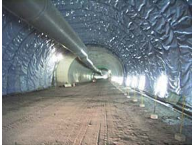
図 5-3-5 防水シートの施工例（一般国道 191 号線 萩・三隅道路） （国土交通省 中国地方整備局 山口河川国道事務所ホームページより抜粋）
