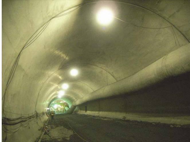
図 5-3-6 覆エコンクリートの施工例（一般県道 常神三方線 神子トンネル） （福井県 敦賀土木事務所 道路改良主要事業 ホームページより抜粋）
