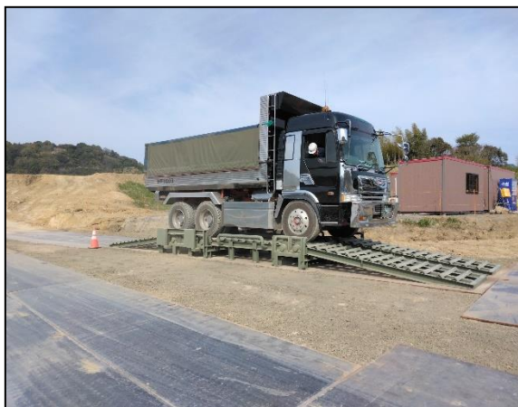
写真5 洗車設備 (タイヤ洗浄機)
