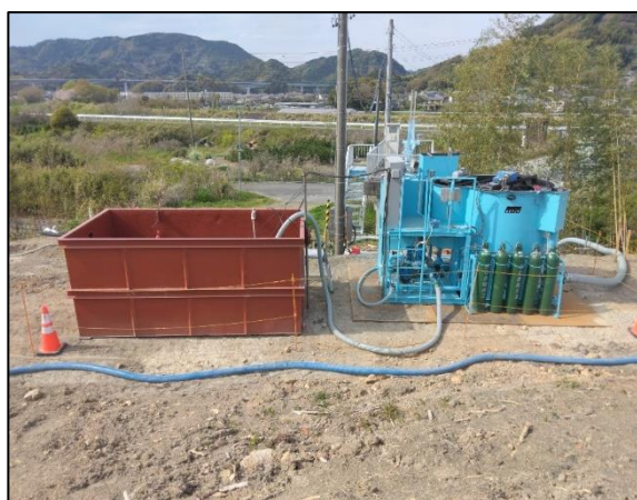
写真 2 濁水処理装置
