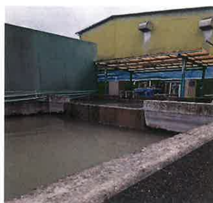
調整池 分離槽 対策後 R2. 7. 31
