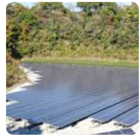
太陽光発電施設
