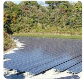
太陽光発電施設
