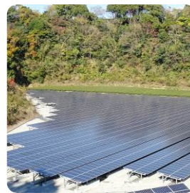
太陽光発電施設
