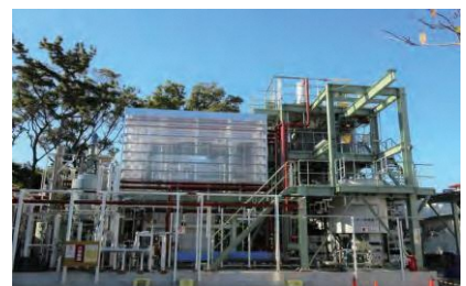
水熱炭化設備の外観
