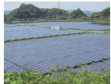
採石場跡地に建設された太陽光発電所
