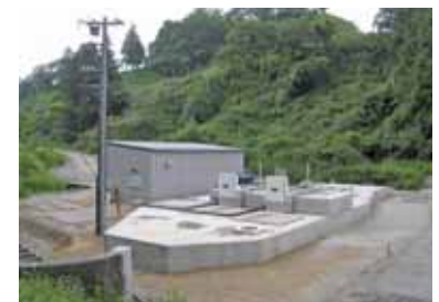
農業用水を活用した小水力発電西方発電所（菊川市）
