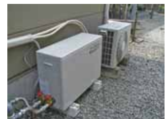
室外機 (左側：地下水熱利用、 右側：空気熱利用)
