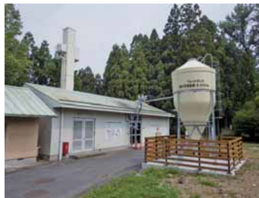
木質ペレット空調設備の全景
