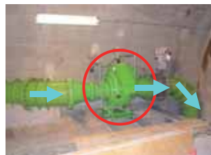
発電機一体型のリング水車を導入
