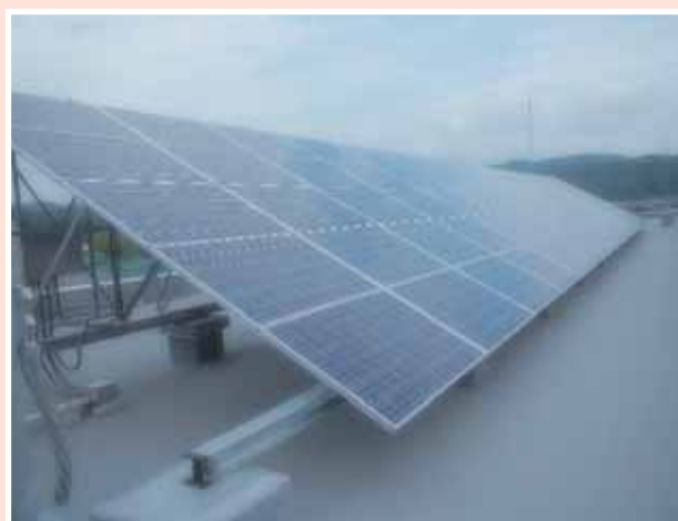
太陽光発電設備導入事例（県立天竜高等学校）
