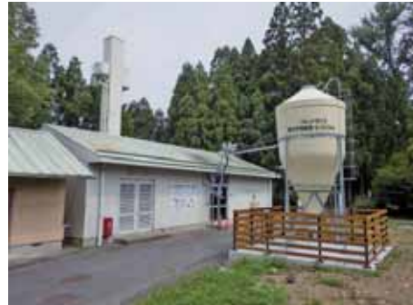
木質ペレット空調設備の全景
