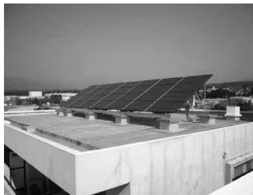
県営住宅での太陽光発電設備導入事例
