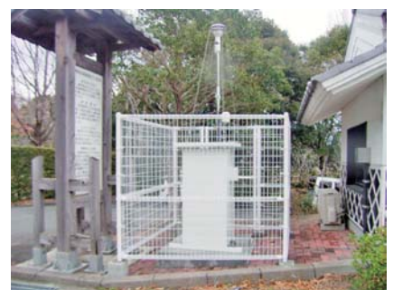
PM2.5 自動測定器（掛川市）
