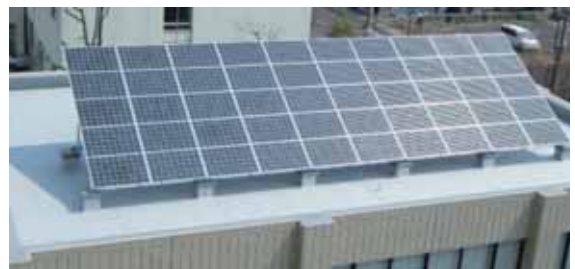
環境衛生科学研究所屋上の10kWの太陽光パネル
