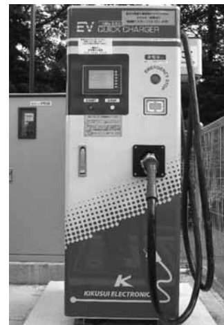
県庁本館前の急速充電器
