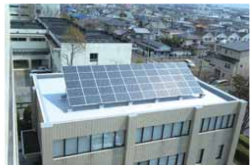
県有施設への率先導入（環境衛生科学研究所）
