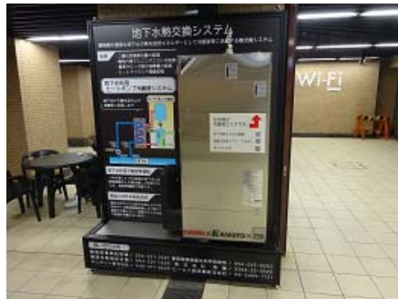
ヒートポンプ側
