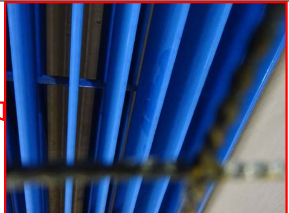
地下水熱交換システム
