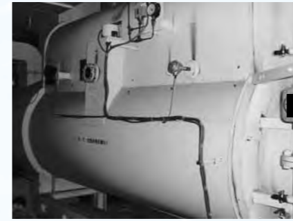
改善前: ガス焚吸収式冷凍機
