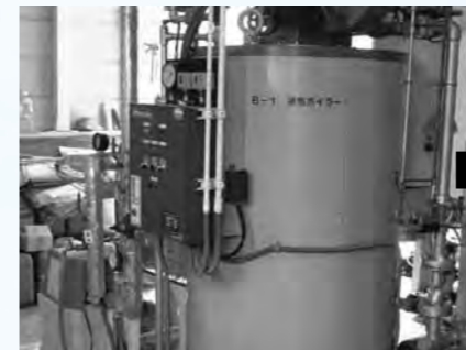
改善前: 蒸気ボイラ
