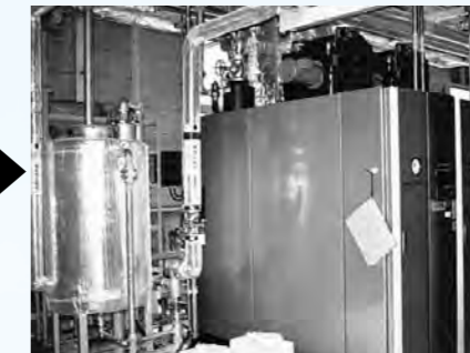
改善後: 高効率蒸気ボイラ
