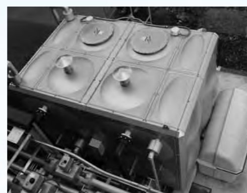
<蓄熱槽・貯湯槽>
