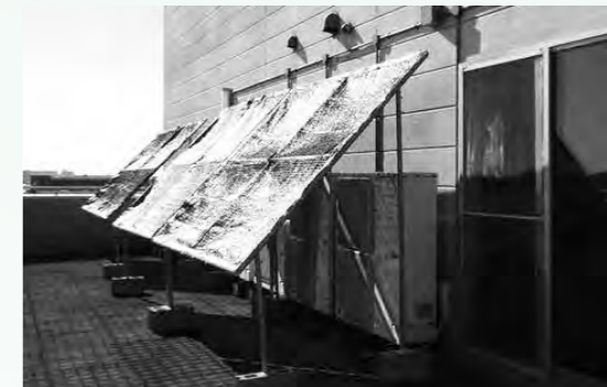
エアコン室外機の日除け
