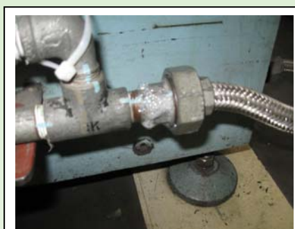
<エア－漏れ修理前>
