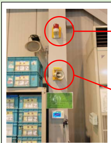
<デマンド監視装置と警報システム>
