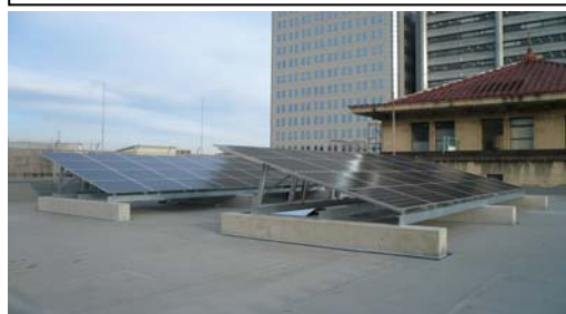
太陽光発電施設（県庁本庁舎屋上）
