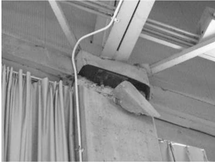
写真3. 2-1 定着部における側方破壊の例
