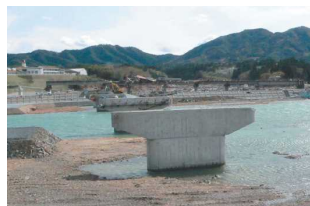
津波で落ちた橋 (東日本大震災)
