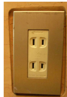
【写真7】別館商用回路コンセント例
