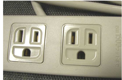
【写真3】東館商用回路コンセント例
